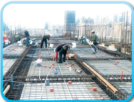
▲ 7樓頂版配水電管
