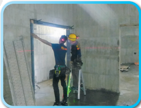
▲ 地下室防火門立框
