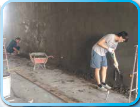
▲ 三樓牆面水泥粉刷
