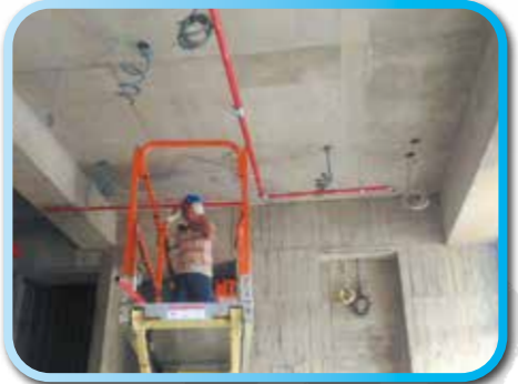
▲ 一樓消防配管
